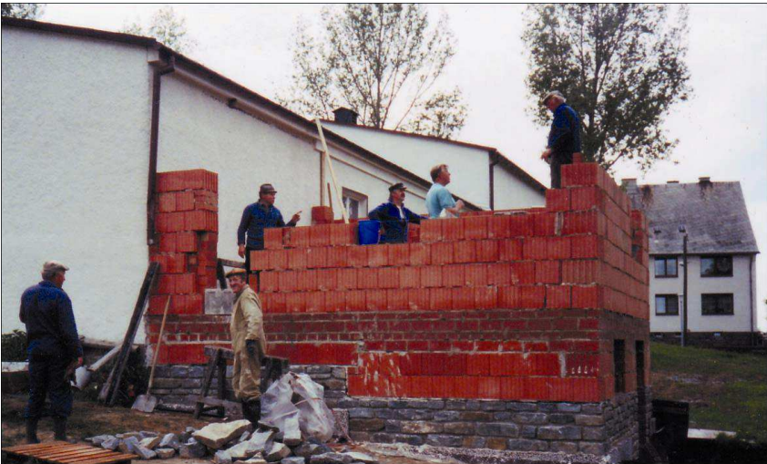
Arbeiten bei der Errichtung des Küchen- und Sanitärtraktes an der Züchterklausen. Im Bild von links: Zuchtfreunde Manfred Lorenz, Karlheinz Siegert, Rolf Teucher, Hans-Jürgen Lorenz, Erhard Teucher und Lothar Haustein.
